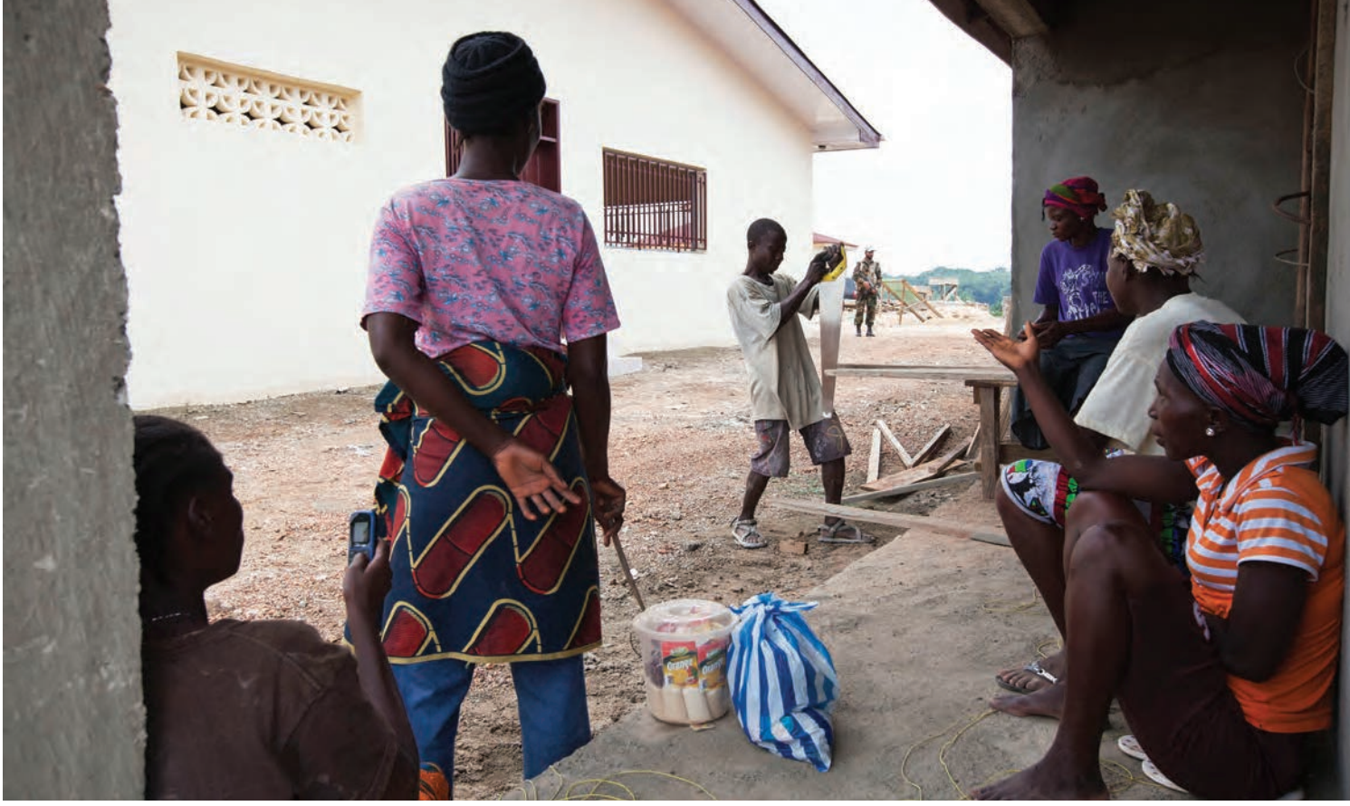
مركز للعدالة والسلام قيد الإنشاء في غبارنغا، ليبيريا. يعكف صندوق بناء السلام التابع للأمم المتحدة على تمويل هذه المبادرة الجديدة. مصدر الصورة: صور الأمم المتحدة/ ستانوتون وينتر
